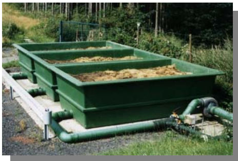
3 Kompostfilter in Betrieb
